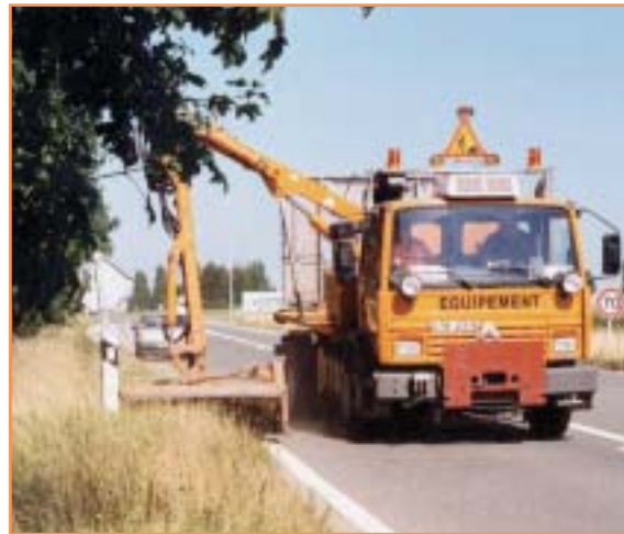
Le parc matériel de la DDE du Bas-Rhin loue ses machines aux 16 subdivisions du département.
